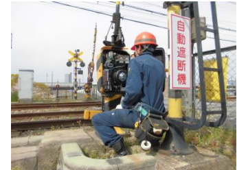
踏切保安装置の定期検査
