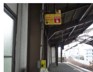
非常通報ボタン
