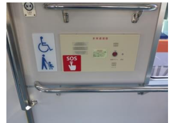
非常通話装置
