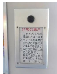
非常通報装置
