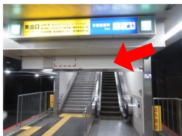
防火防煙シャッター
