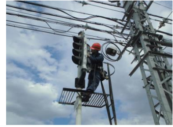
信号機の定期検査
