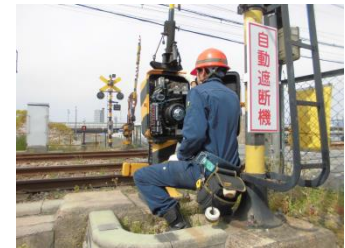
踏切保安装置の定期検査
