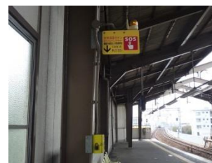
非常通報ボタン
