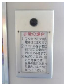
非常通報装置
