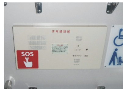
非常通話装置
