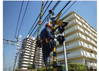
踏切保安装置の定期検査
