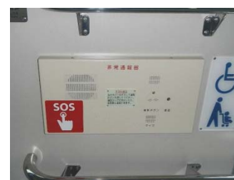
非常通話装置
