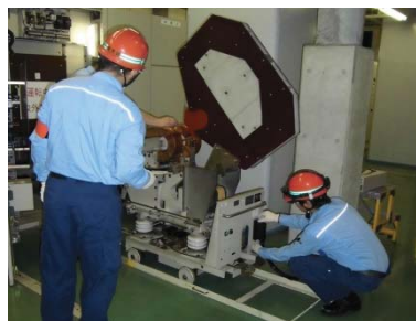
変電設備障害復旧訓練
