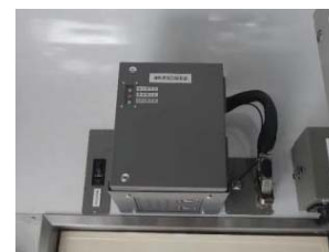
運転状況記録装置
