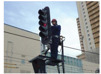
信号機の定期検査
