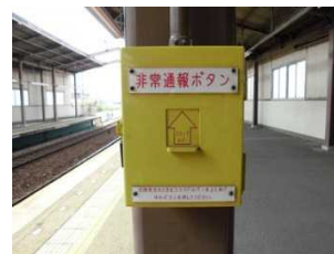
非常通報ボタン
