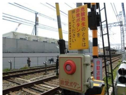
非常押ボタン
