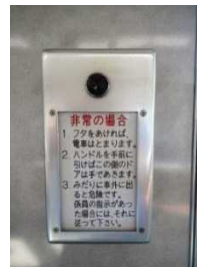
非常通報装置
