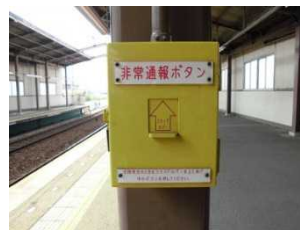
非常通報ボタン
