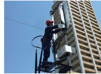
信号機の定期検査
