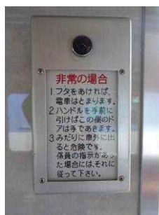
非常通報装置
