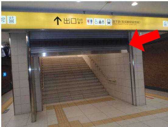
防火防煙シャッター
