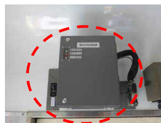
運転状況記録装置
