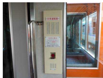
非常通話装置
