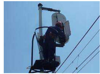
信号機の定期検査
