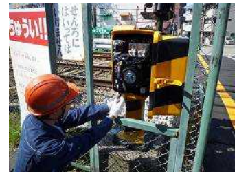
踏切保安装置の定期検査
