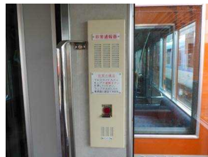
非常通話装置
