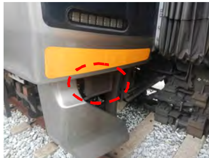
破線内が転落防止放送装置
