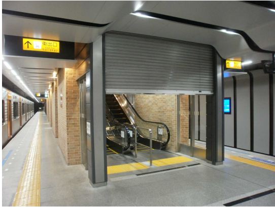
防火防煙シャッター
