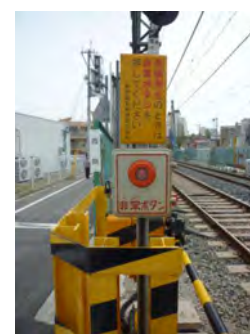
非常押ボタン
