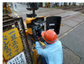
踏切保安装置の定期検査
