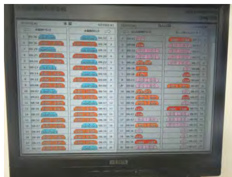
車両在線表示システムモニタ（本線）
