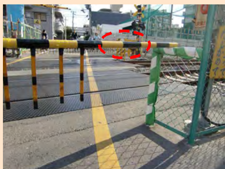
スリット形踏切遮断桿（設置状況）
