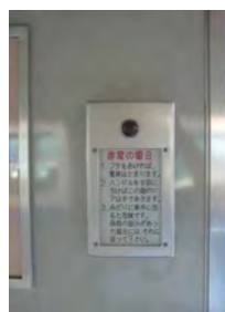
非常通報装置
