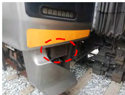
破線内が転落防止放送装置
