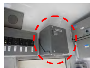
運転状況記録装置
