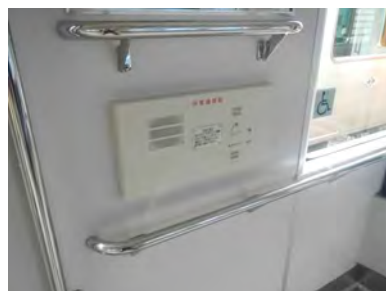
非常通話装置
