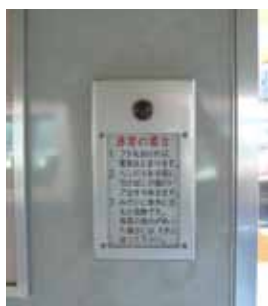
非常通報装置
