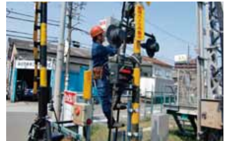
踏切保安装置の定期検査
