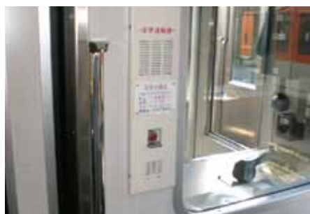
非常通話装置
