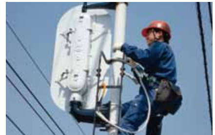
信号機の定期検査
