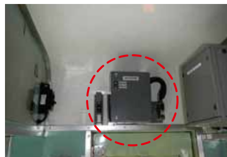
運転状況記録装置
