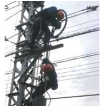
電車線自動張力調整装置点検
