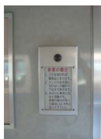
非常通報装置
