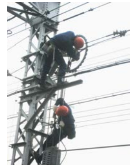
電車線自動張力調整装置点検
