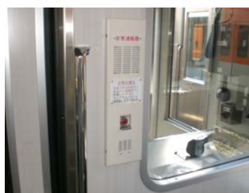
非常通話装置
