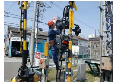
踏切保安装置の定期検査
