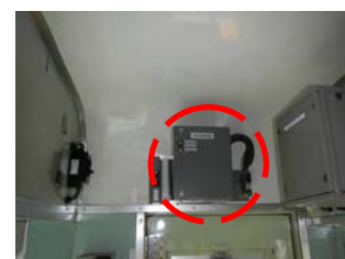
運転状況記録装置
