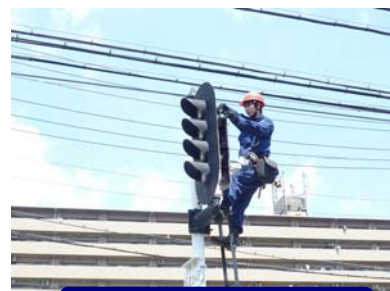
【信号機の定期検査】
