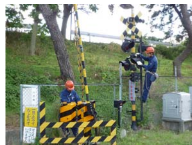
【踏切保安装置の定期検査】
