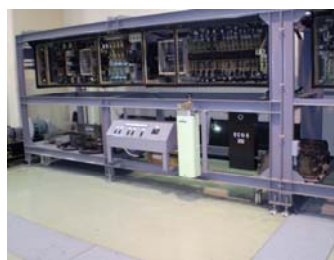
【車両構造教育用の設備】
