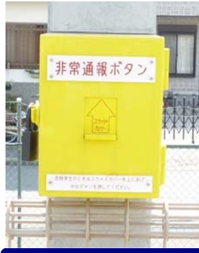
【非常通報ボタン】
