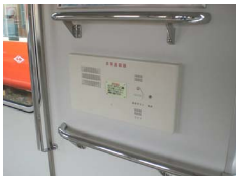
【非常通話装置（非常通報器）】
