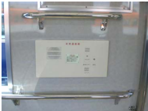
【非常通話装置(非常通報器)】
