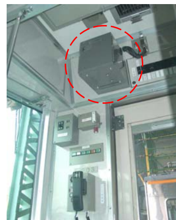
【破線で囲んだ機器が運転状況記録装置】
