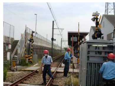
【踏切保安装置の定期検査】
