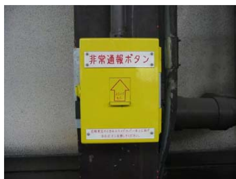
【非常通報ボタン】
