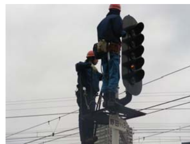
【信号機の定期検査】
