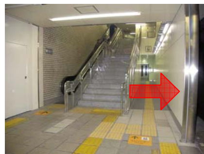
【防火防煙シャッター】
