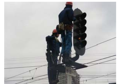
【信号機の定期検査】
