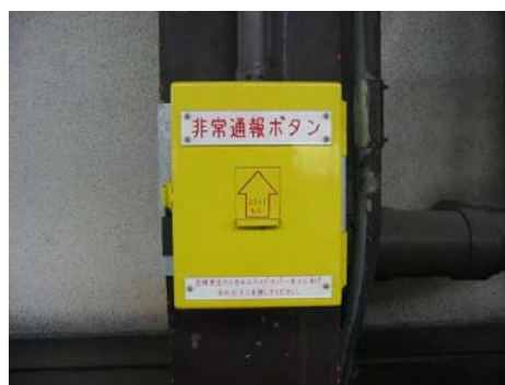
【非常通報ボタン】
