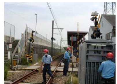
【踏切保安装置の定期検査】
