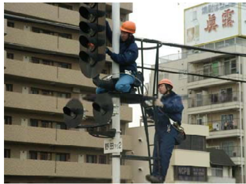
【信号機の定期検査】
