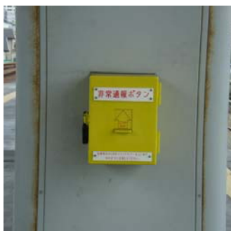
【非常通報ボタン】
