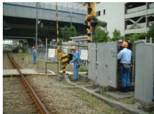
【踏切保安装置の定期検査】
