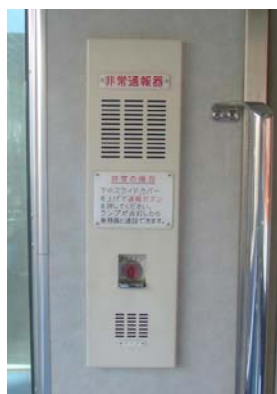
【非常通話装置（非常通報器）】
