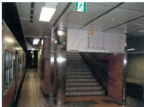
【防火防煙シャッター】
