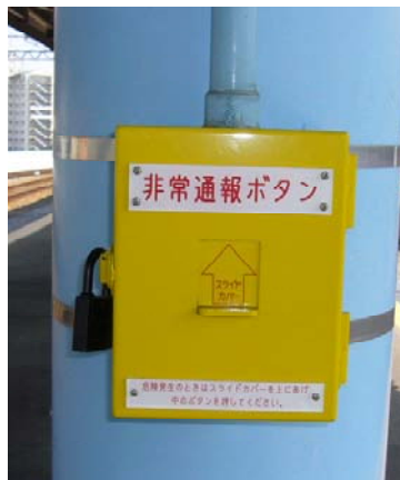
【非常通報ボタン】
