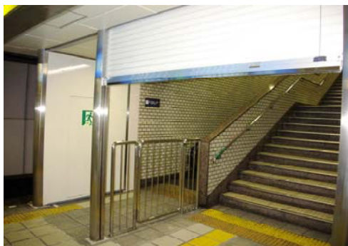
【防火防煙シャッター】
