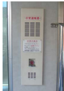
【非常通話装置（非常通報器）】
