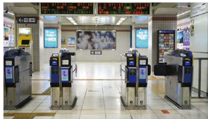
車いす対応改札機
