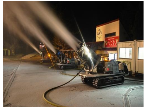
スノーファン 稼働時の様子
