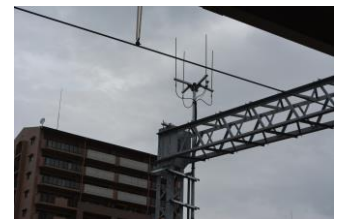
大石駅に設置した 基地局アンテナ
